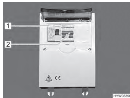
Bild 116 230-V-Sicherungskasten mit Leitungsschutzschalter und FI-Schalter
